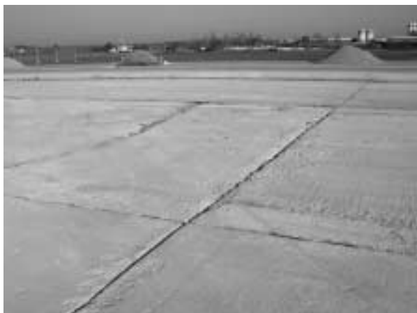
Obr. 8: RWY 06-24, rozlámané desky spodního betonu, koroze povrchu betonu zejména v okolí spár.
