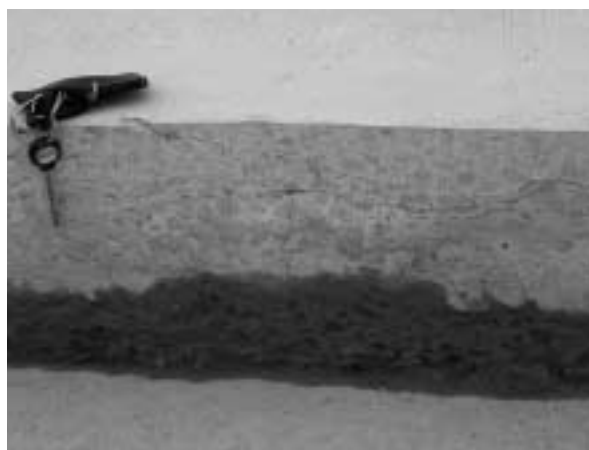
Obr. 5: RWY 13-31, u jednovrstvové desky horizontální usmyknutí vrstvy betonu, degradace spodního líce desky.
