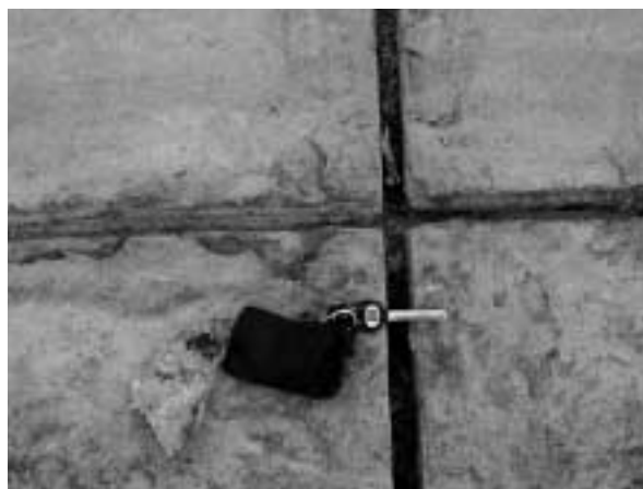
Obr. 7: RWY 13-31, spáry ve spodní desce, šířka spár cca 25 mm.
