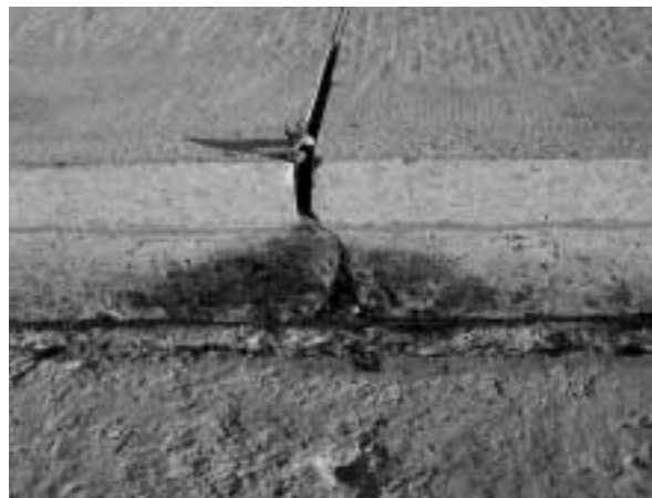
Obr. 11: RWY 06-24, koroze spodního líce desky u příčné spáry.
