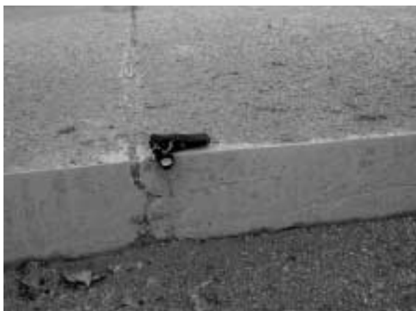
Obr. 6: RWY 13-31, horizontální usmyknutí vrstvy betonu, deska betonovaná v jedné vrstvě, beton jinak nepoškozený.
