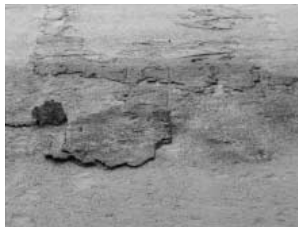
Obr. 3: RWY 13-31, zbytky kluzné mezivrstvy pod horní deskou.
