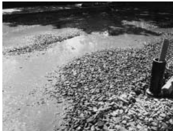
Obr. 2: Nevyhovující rovinatost a technologie hutnění.
