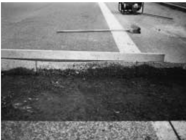
Obr. 3: Pražská radiála, větev A, kopaná sonda 4, pokles asfaltových vrstev o 35 mm.
